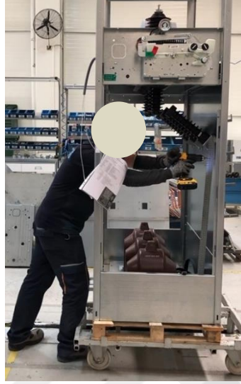
Şekil 35 Operatörün kablo kanallarını şarjlı el matkabı ile montaj işlemi alt faaliyeti adımı
