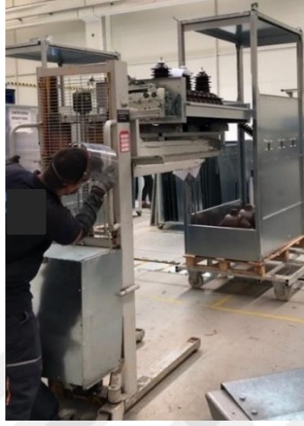
Şekil 32 Ayırıcı kazanlarının taşıma ekipmanı ile hücre içine aktarılması alt faaliyet adımı ve operatörün görüş mesafesi
