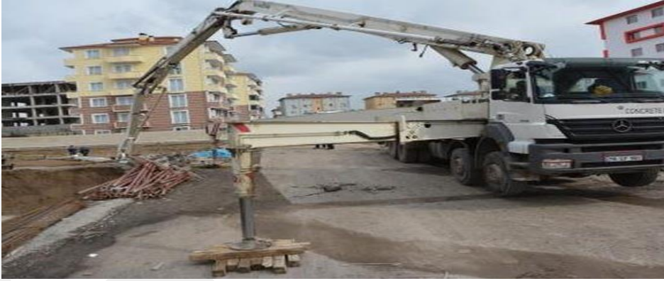
Şekil 15 Mobil Beton Pompası Ölümlü Kaza[36]
