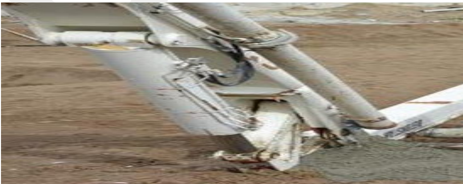
Şekil 16 Mobil Beton Pompası Ölümlü Kaza[36]
