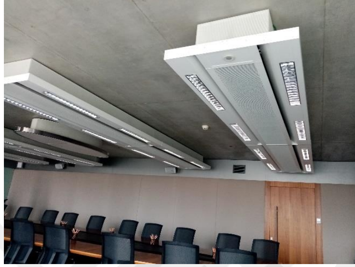
Şekil 4.7: Türkiye Mühendisler Birliği Binası Soğuk Kiriş Sistemi
