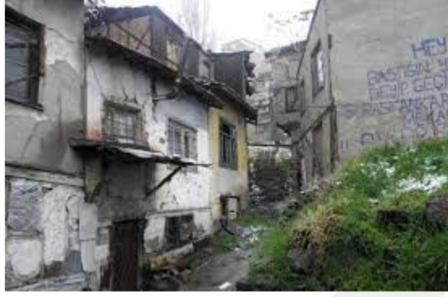
Şekil 92: Çöküntü Bölgesine Dönüşen Hacidoğan Mahallesiindeki Evler (URL-44)
