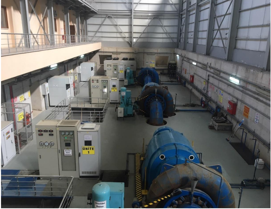
Şekil 21 Santral Binası ve Türbinler
