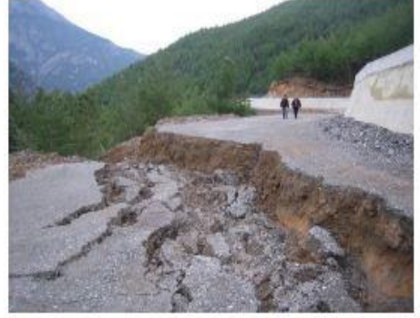
Yer kayması sonucunda yolda oluşan çatlaklar
