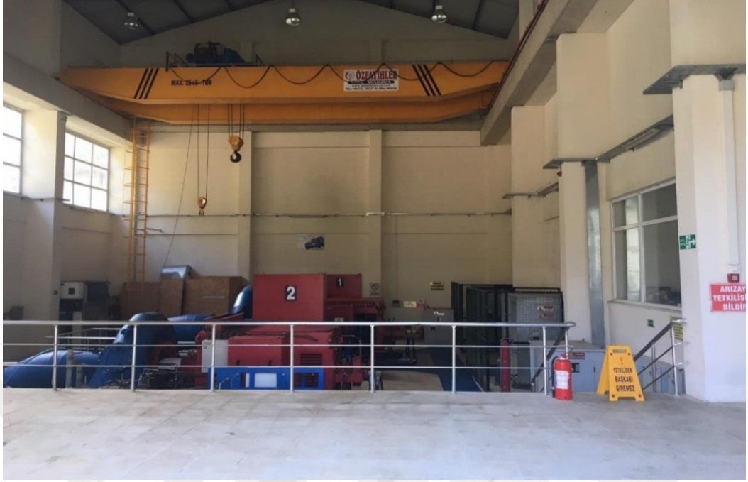
Şekil 12 Santral Binası ve Türbinler
