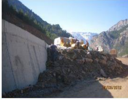
Toprak kayması neticesinde hasarlanmış istinat duvarı
