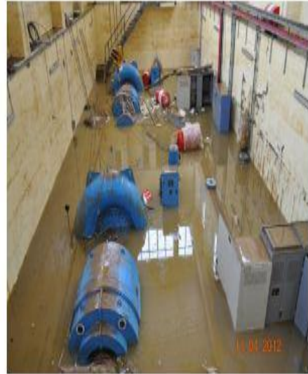
Sel suları altında kalmış türbin holü
