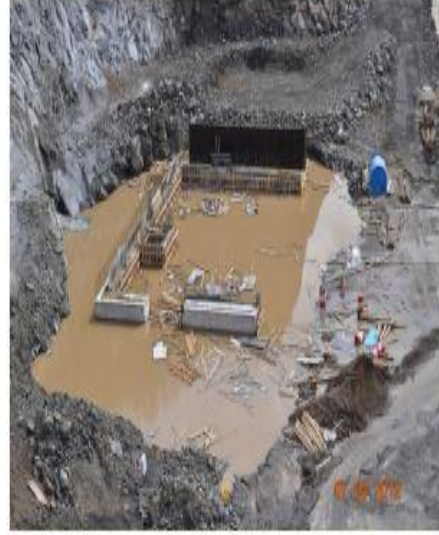
Sel suları altında kalmış inşaat sahası
