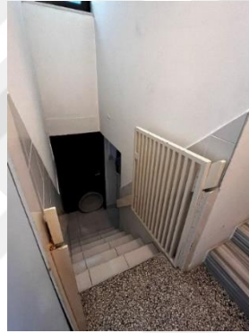
Şekil 4. 25: Esat Sivri Evi, Evin İçinde Bulunan Bodrum Kata iniş Merdiveni (Akmil Kahraman 2022)
