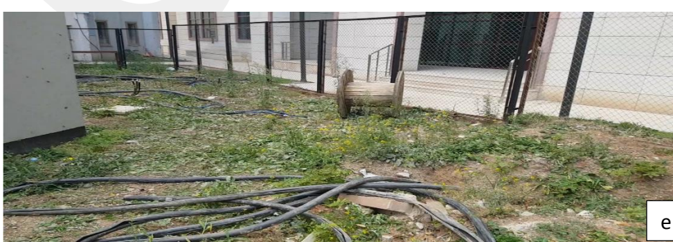
Fotoğraf 63: Trafo ve Enerji Merkezi Alanı Çevre Görünümü
